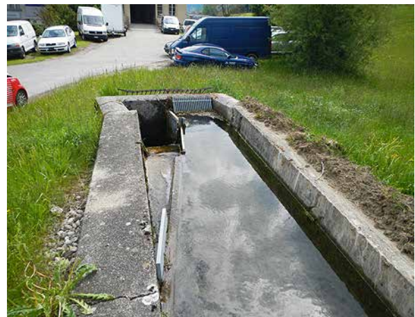
Bild 67 Einlaufrechen mit Entlastung vor dem Einlauf in Richtung Turbine (3.6.2014).
