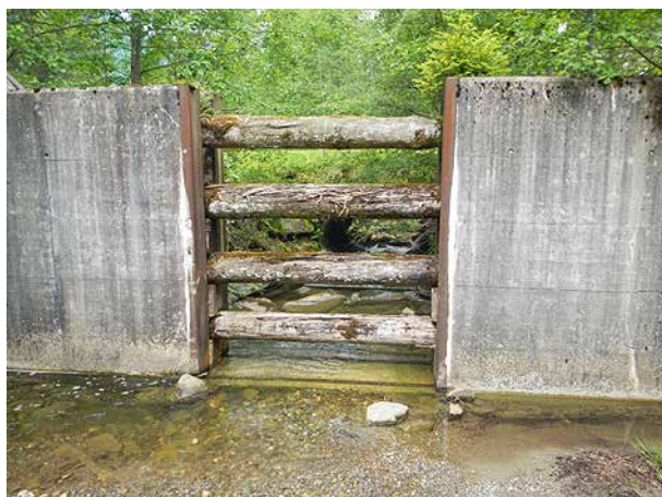
Bild 55 Schwemmholzrechen ohne Verkläuserung, das Geschiebe kann ungehindert weitertransportiert werden (3.6.2014).
