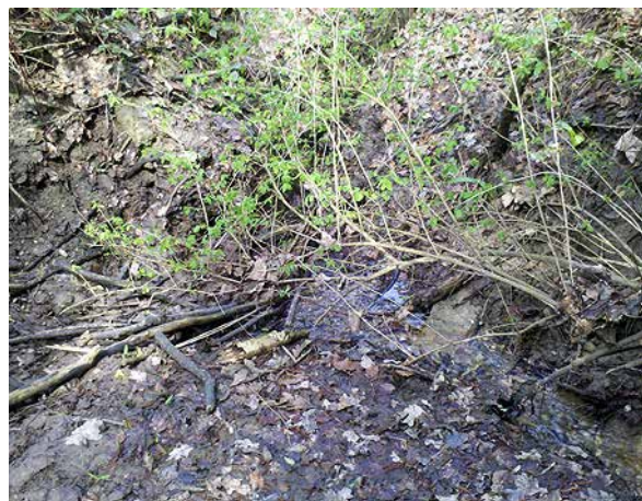
Bild 183 Nicht mehr sichtbarer, verklauter und verschlammter Rohrauslass am Dammfuss (7.4.2014)
