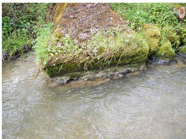
Bild 193 Unterspülte Betonbuhne bachabwärts des Sammlers, die Erosionstendenz deutet auf ein Geschiebedefizit oder eine zu starke Einengung des Gerinnes (3.6.2014).
