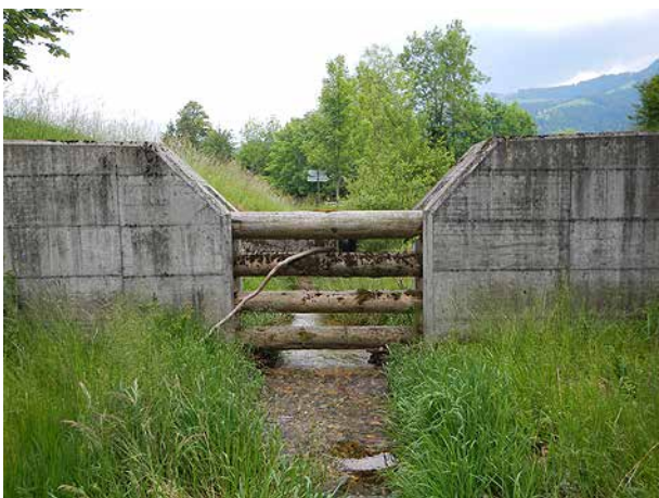
Bild 87 Betonschlitzsperre mit Horizontalrechen aus Rundhölzern, Feingeschiebe wird bei kleinen Hochwassern weiter transportiert (3.6.2014).
