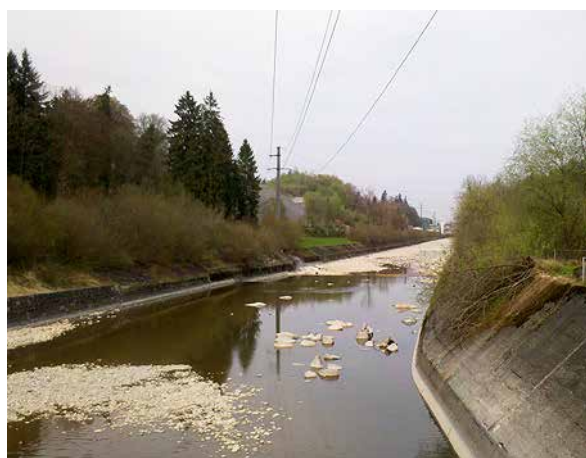
Bild 36 Blick von der Wehranlage emmenabwärts. Das Gerinne ist kanalisiert und begradigt, die Ufer sind fast durchgehend gepflästert (7.4.2014)
