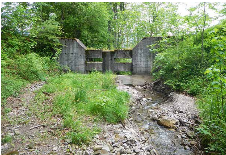
Bild 81 Betonsperre, zu einem Drittel gefüllt, Ablagerungen teilweise überwachsen und wieder erodiert (3.6.2014).
