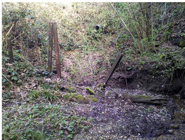
Bild 182 Zerfallener Schwemmholzrechen aus Eisenbahnschienen (7.4.2014).
