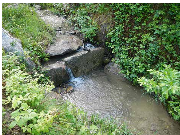
Bild 203 Blockschwelle unterhalb des Sammlers mit lokaler Erosion (3.6.2014).
