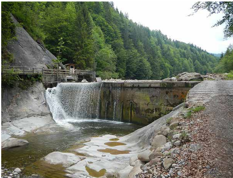
Bild 92 Betonschwelle der Wasserfassung mit seitlicher Entnahme über Einlaufrechen und am Rande der Schwelle angeordnetem Spülschütz (3.6.2014).
