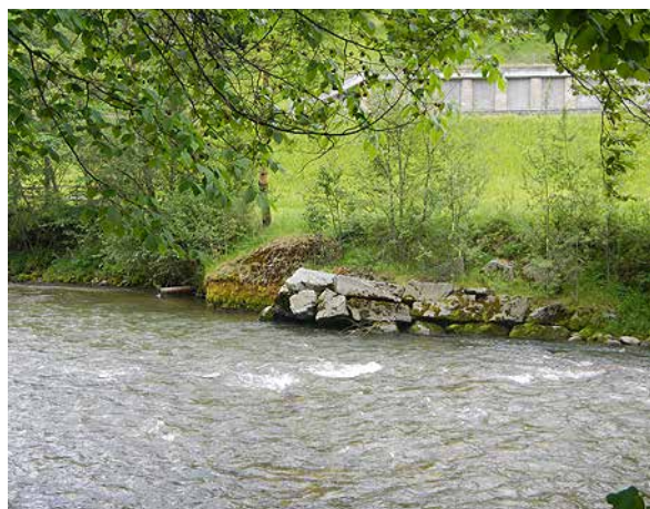
Bild 3 Mit Blöcken verstärkte Betonbuhne, welche am Buhnenkopf wieder unterspült wurde (3.6.2014).
