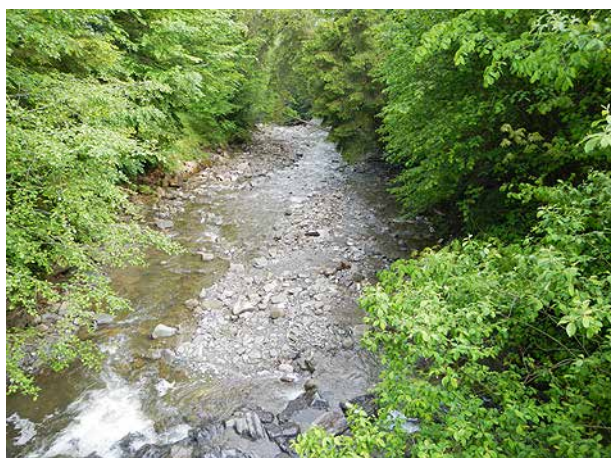
Bild 198 Geschiebeablagerungen zwischen den Betonschwellen bachabwärts der Entnahmestelle (3.6.2014).
