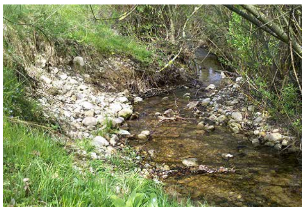
Bild 172 Mehrere Uferanrisse im naturnahen Gerinne gerade unterhalb des Sammlers. Wird weniger Geschiebe zurückgehalten, so verringern sich die Erosionsprobleme unterhalb (7.4.2014).
