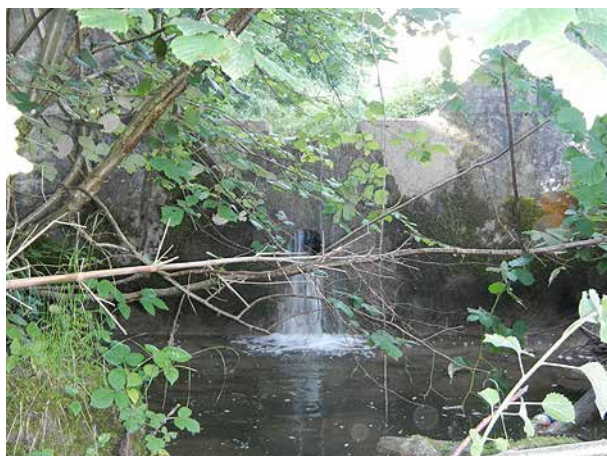
Bild 157 Blick bachaufwärts auf die Betonsperre. Das etwas tiefer liegende Rundloch ist verklaust und staut den Sammler ein (26.6.2014).
