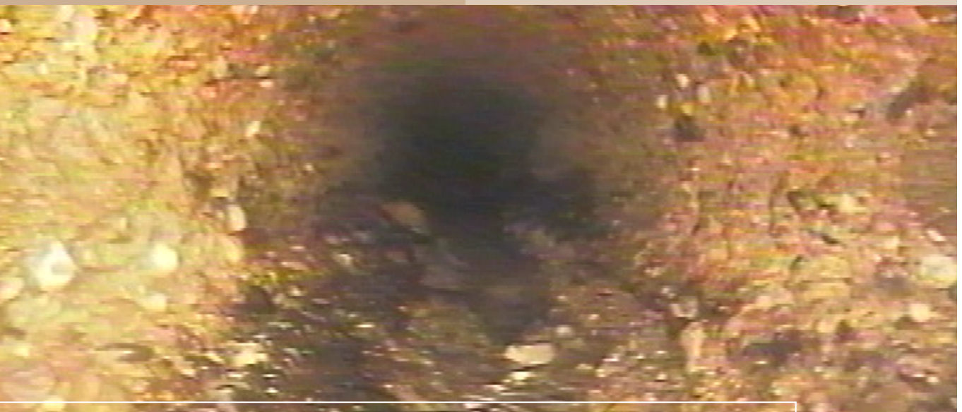
Stark ausgewaschenes Kanalisationsrohr
